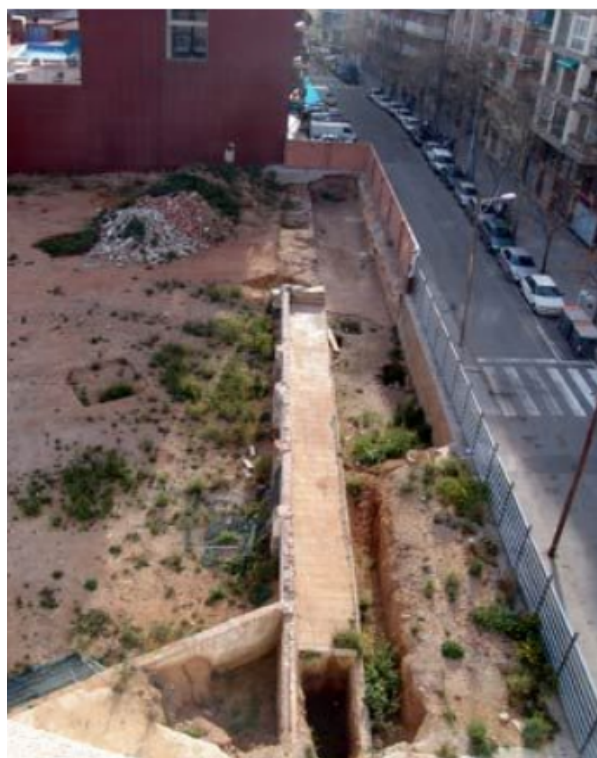
Tram del Rec Comtal al carrer Ciutat d'Elx, prop de la intersecció amb el Carrer Costa Rica.
